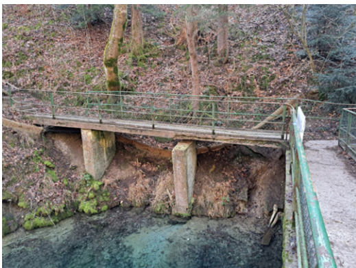
Bildunterschrift Bild 1: Einsturzgefährdeter Steg in der Teufelsküche. (Foto: Stadtwerke Landsberg KU, zum Abdruck frei)
